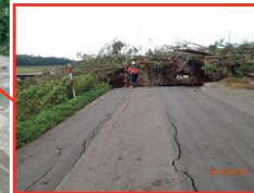
捜索現場の上の道路の変状（亀裂・傾斜）
