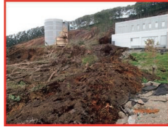
浄水場の地盤の崩壊
